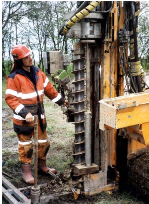
Figur 8.11 Förborring med "hollow stem auger". Den förberedda provtagaren som är klar att sänkas ned i centrumhålet syns upphängd framför skruven.
