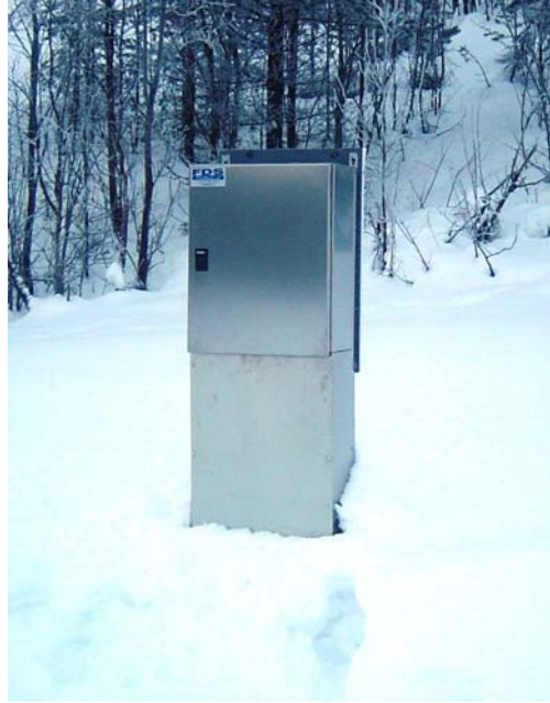
Figur 12.32 Samma mätskåp vid olika årstider. Skåpet innehåller logger, multiplexor, kommunikationsutrustning och strömförsörjning samt värmeelement.
