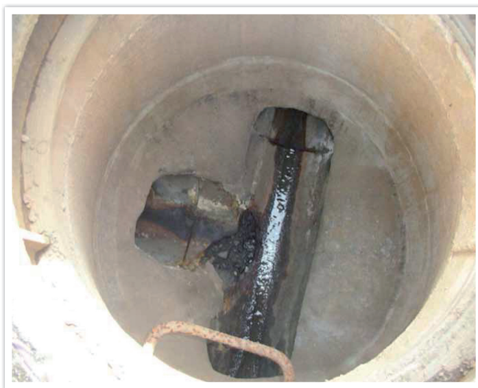
Figur 7 Foto på dagvattenbrunn med ett diffust inläckage av grundvatten (Foto: Golder Associates)
