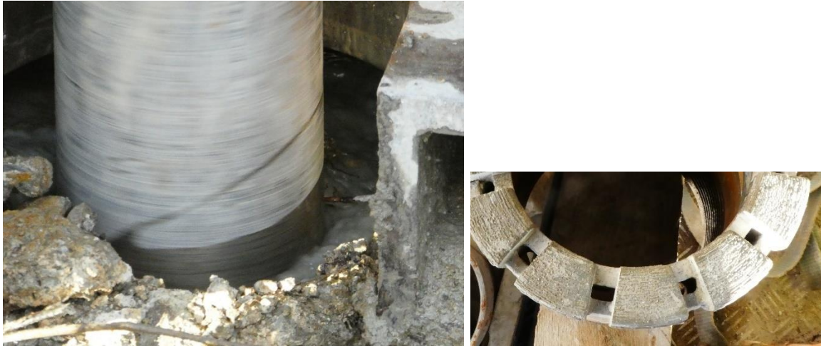
Figur 17 Vatten och borrhax som pressas upp till markytan efter det yttre foderröret till vänster. Borrkrona med hål där vatten spolas ut till höger (Foto: B Dehlbom, SGI).
